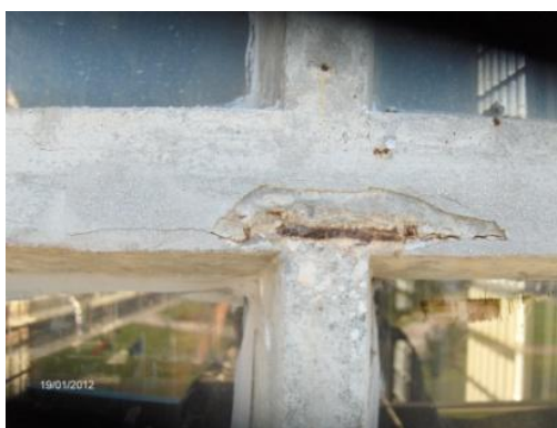
Figura 5.4 - Descasque de recobrimento em elementos de betão armado (fonte: STB).
