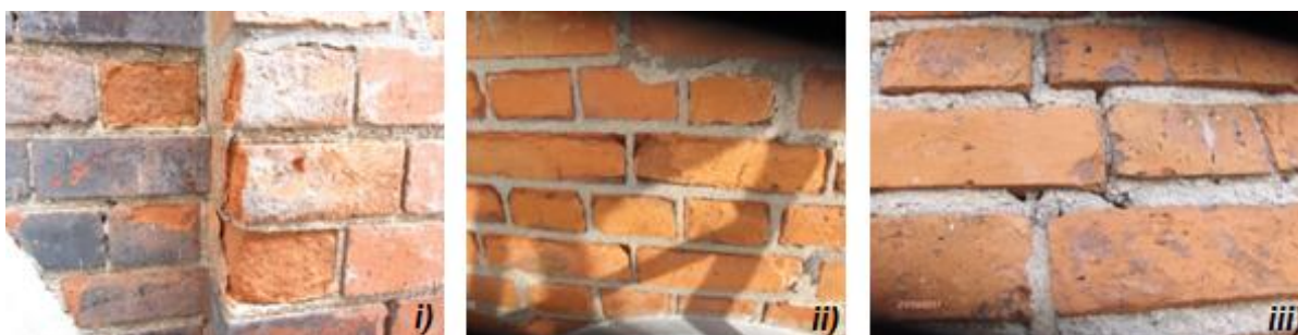
Figura 5.2 – Anomalias em alvenaria de tijolo. i) Delaminação de tijolos e falta de coesão das juntas; ii) degradação de tijolos e iii) falta de material nas juntas (fonte: STB).
