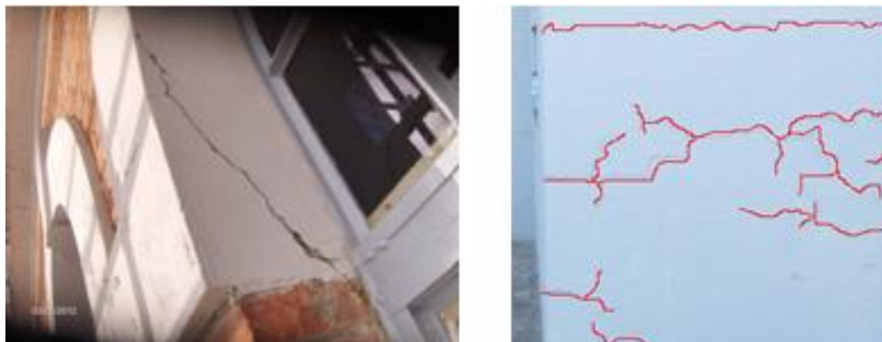
Figura 5.3 - Fendilhação (esquerda) e fissuração (direita) em argamassas de reboco (Costa, Santos, 2010).
