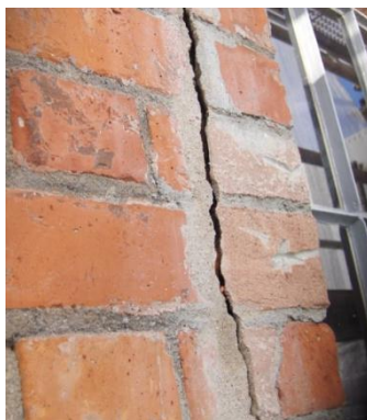
Figura 4.3 – Agravamento da abertura de fendas na zona de anterior injeção de calda (fonte: STB).
