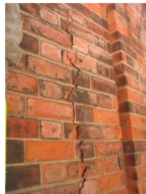
Figura 4.5 – Elementos de alvenaria fraturados (fonte: Fundação EDP).
