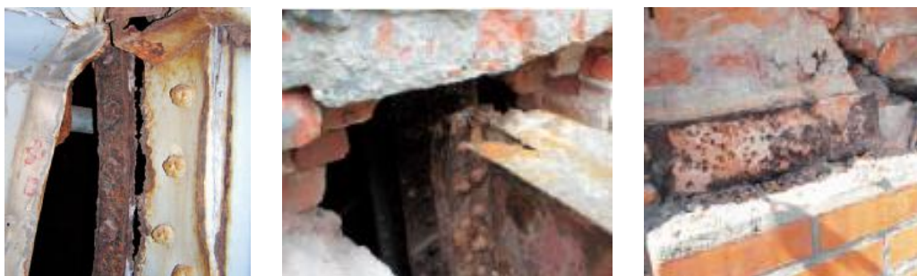
Figura 4.2 – Elementos metálicos corroídos (Santos, Faria et. al, 2006).
