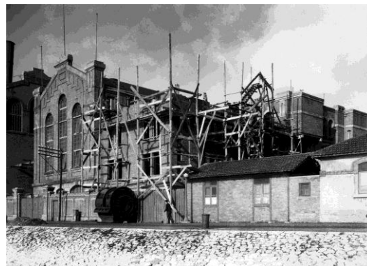
Figura 2.9 – Ampliação da Subestação Elevadora de Tensão (vista SE) (fonte: cdme).
