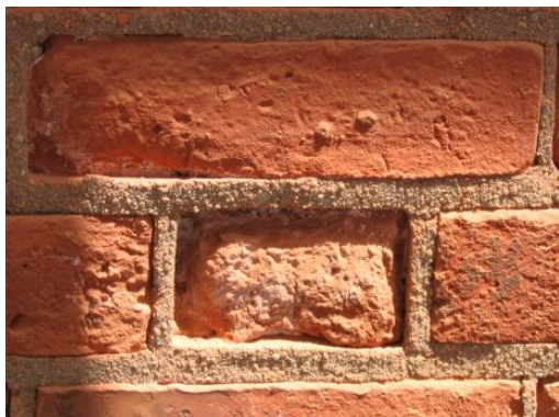
Figura 4.4 – Degradação dos tijolos (fonte: Fundação EDP).
