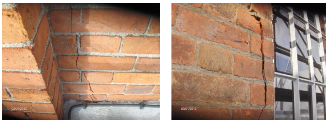
Figura 5.1 – Fissuração e fendilhação de panos de alvenaria (fonte: STB).
