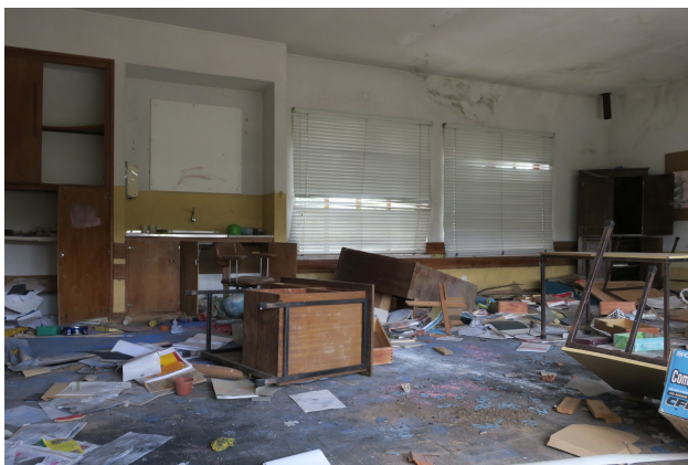
Fig. 33 | Degradação de uma sala de aula, evidenciando infiltração e marcas de vandalismo.
