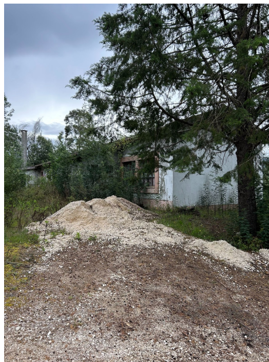
Fig. 36 | Fachada a nordeste, evidenciando o avanço da vegetação na envolvente.
