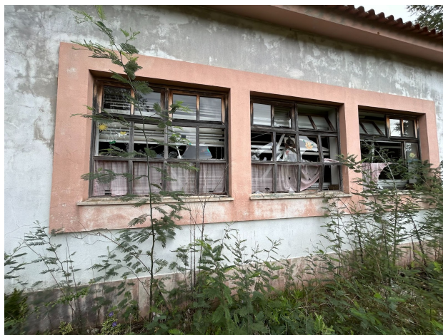
Fig. 34 | Vista da fachada principal, com sinais de vandalismo nas janelas.
