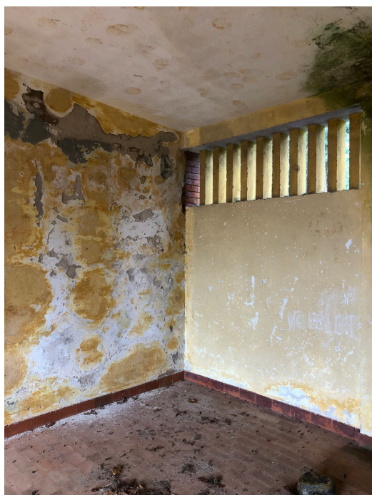
Fig. 29 | Condições estruturais do alpendre da Escola Primária de Sarnadela.
