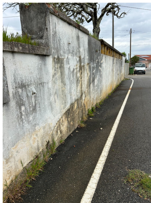
Fig. 22 | Vista lateral do terreno da escola, evidenciando a ausência de zona pedonal segura.
