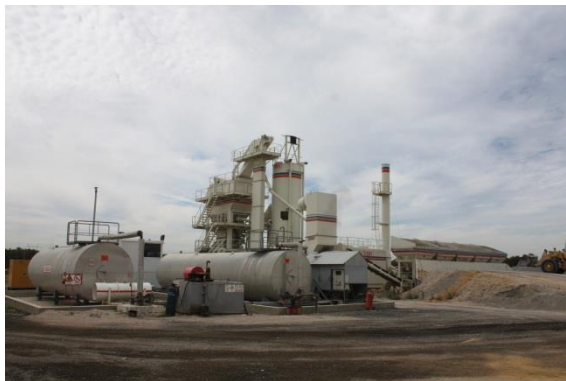
Figura 6.8 – Vista geral da central descontínua utilizada no fabrico da mistura SMA 12 com fibras celulósicas
