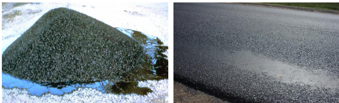
Figura 3.19 – Escorrimento de material betuminoso (à esquerda, JRS, Rettenmaier, 2007) e exsudação (à direita, JRS, Rettenmaier, 2005a)
