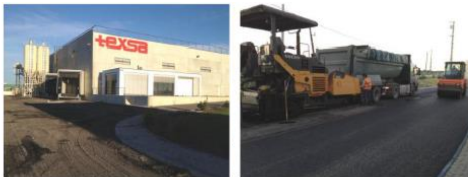
Figura 6.18 – Arruamentos e parque de estacionamento da fábrica da TEXSA e respetivos trabalhos de pavimentação (Martinho et al. , 2013)
