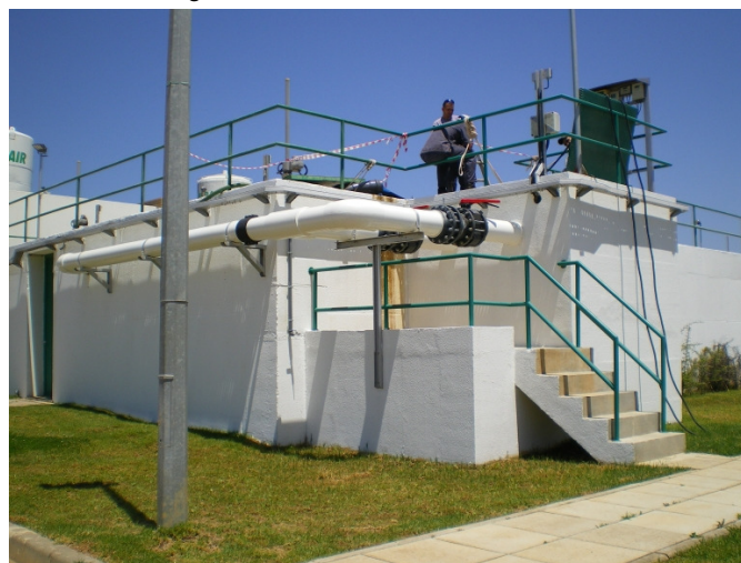
Figura A5.1. 4 - ETA de Alcantarilha
