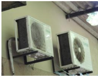
Fig. VI.63 Aparelhos de refrigeração na CMU.
