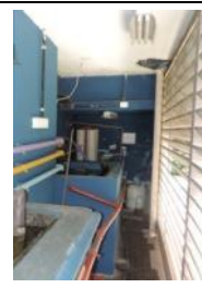
Fig. VI.58 Filtros de água no aquário.
