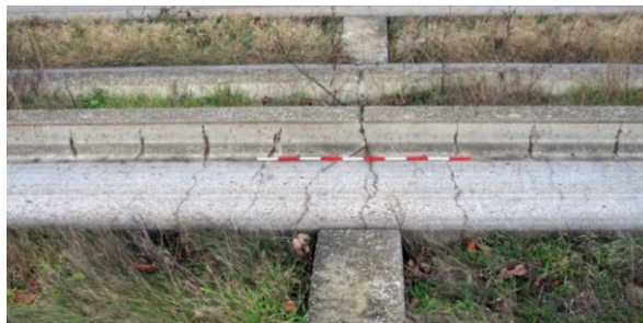
Figura 3.9 – Patologias visíveis no SGMec em Cambridge (Cushing, et al., 2017)
