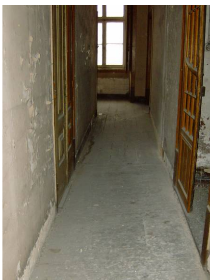
Fig. 22 – Desnívelamento do piso
