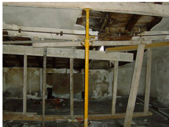
Fig. 25 - Imagem onde se pode observar o estado de degradação da estrutura
