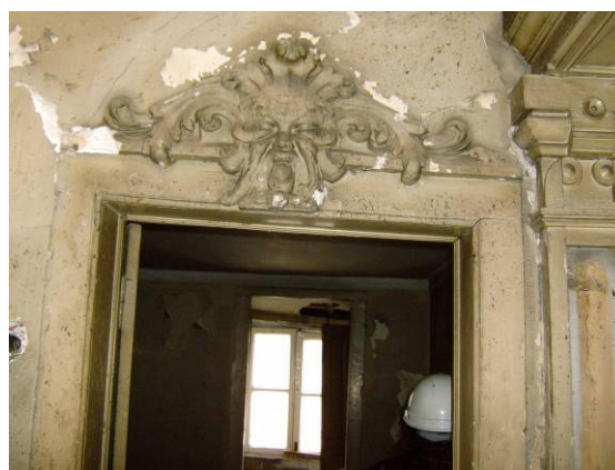
Fig. 23 – Desnívelamento das aberturas, com ocorrência de fendas
