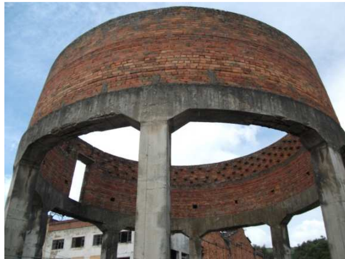
Figura 15 – Detalhe da torre de refrigeração (Foto do autor)
