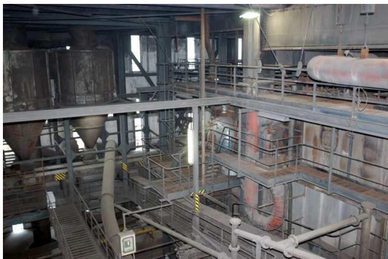
Figura 17 – Caldeiras da central da Tapada do Outeiro (Foto do arquivo do autor)
