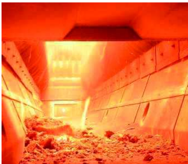
Figura 26 – Sistema de extracção a seco (Fonte: Magaldi)
