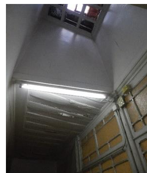
Figura 25 - Zona do segundo lanço de escadas onde é evidente a adaptação grosseira de uma clarabóia (Por Appleton & Domingos Arquitectos)
